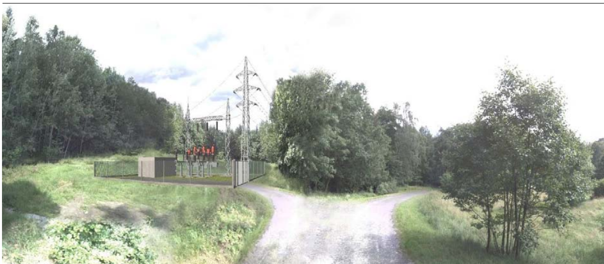
Přechodová stanice - konec kabelové trasy Střed v Novém Boru
